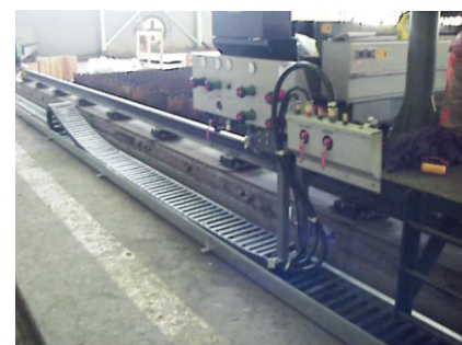
Esteira instalada em percurso de 50 metros em máquina de corte.
